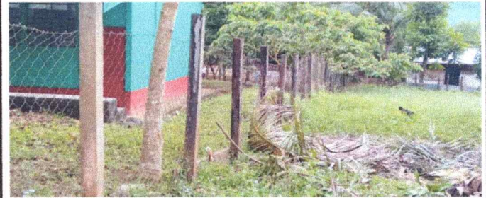
FOTO No. 4 SE OBSERVA MALLA EN MAL ESTADO NECESITA SER SUSTITUIDA
